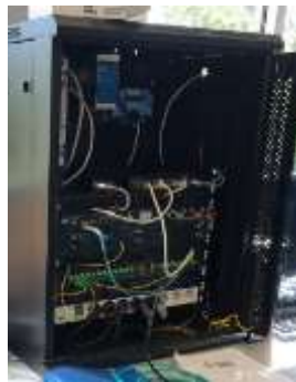
Equipement réseau Fibre Optique
